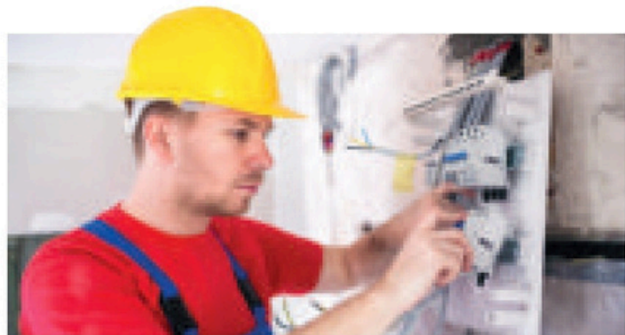
Gut gemachte Elektroinstallationen können bis zu 50 Jahre halten.
